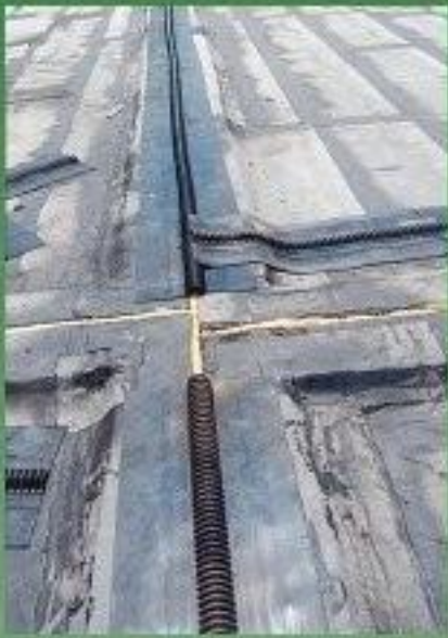
Situația înainte de vulcanizarea îmbinărilor cap la cap, metrajul este deja poziționat.
